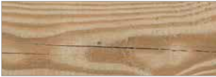
Trocknungsrisse (nach DIN zulässig)
